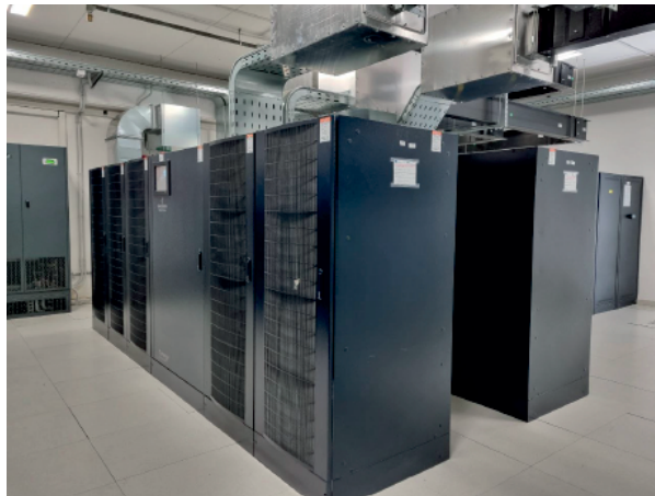
Attuale UPS da 1000kW con 5 core da 200kW
